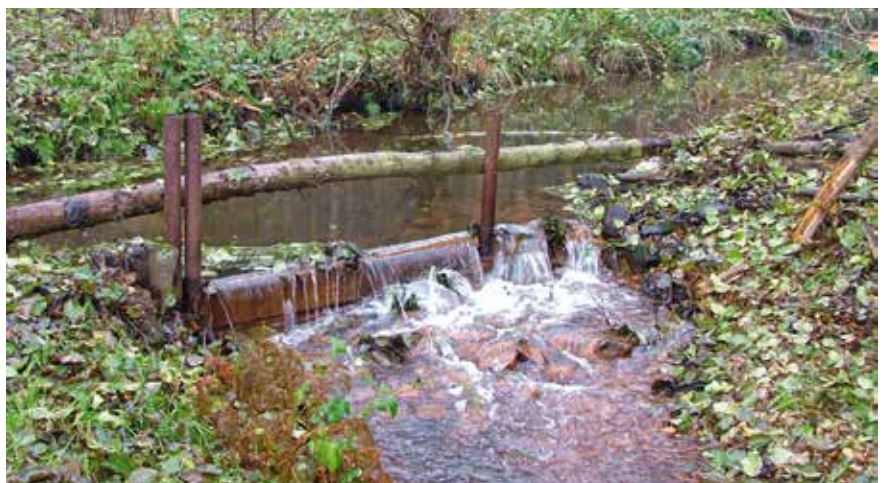
Dieser Sohlabsturz im Mühlenbach war ein Wanderhindernis für die Gewässerlebewesen.
