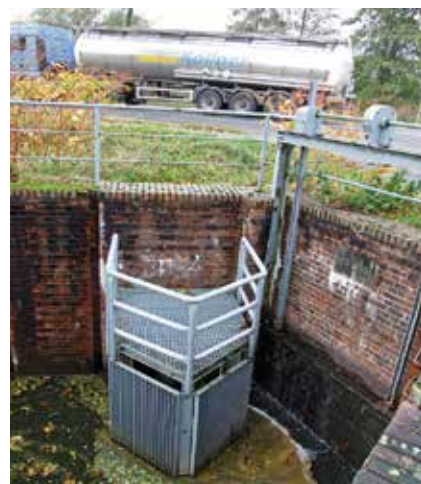
...die Verbindung der Feuchtgebiete ist durch einen derartigen Düker unterbrochen.
