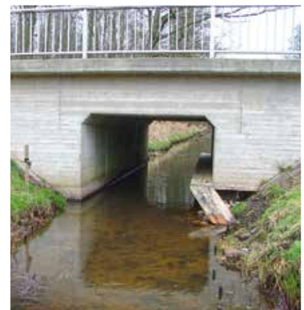
An dieser „engen“ Brücke über die Bomlitz wurde ein Laufbrett angebracht.
