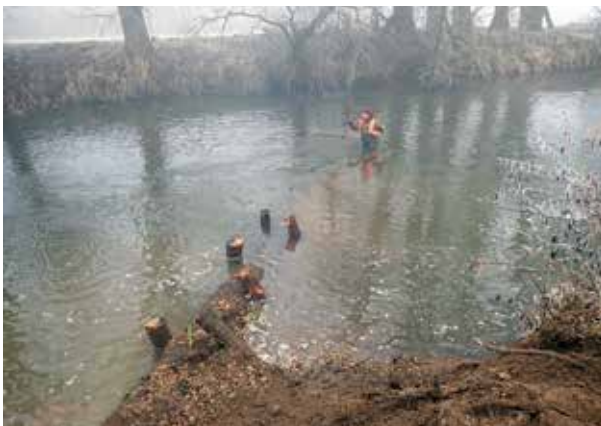
Ob die Stammhölzer in der Oker auf der Sohle aufliegen, musste stellenweise geprüft werden.
